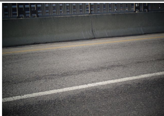
S9 아스콘 균열 (양평방향)
