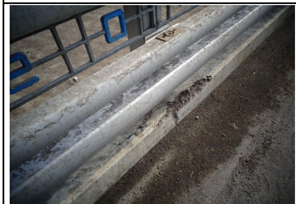
S31 연석 파손 (양평방향)
