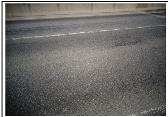
S5 아스콘 균열 (원주방향)
