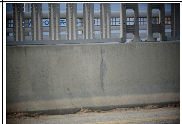
S24 중분대 균열 (양평방향)
