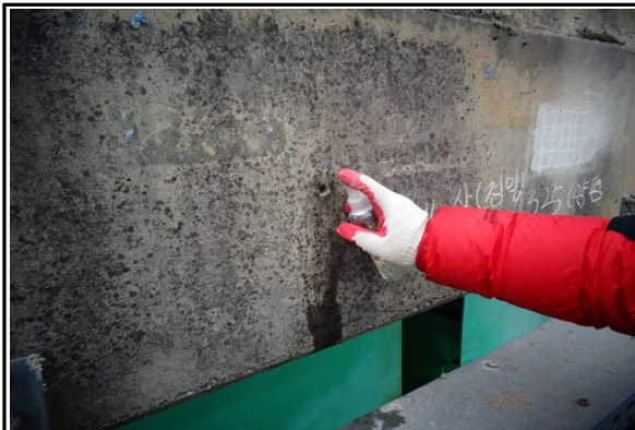
페놀프탈레인 용액 측정(드릴링)
