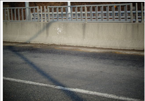
S32 망상균열 및 소성변형 (원주방향)
