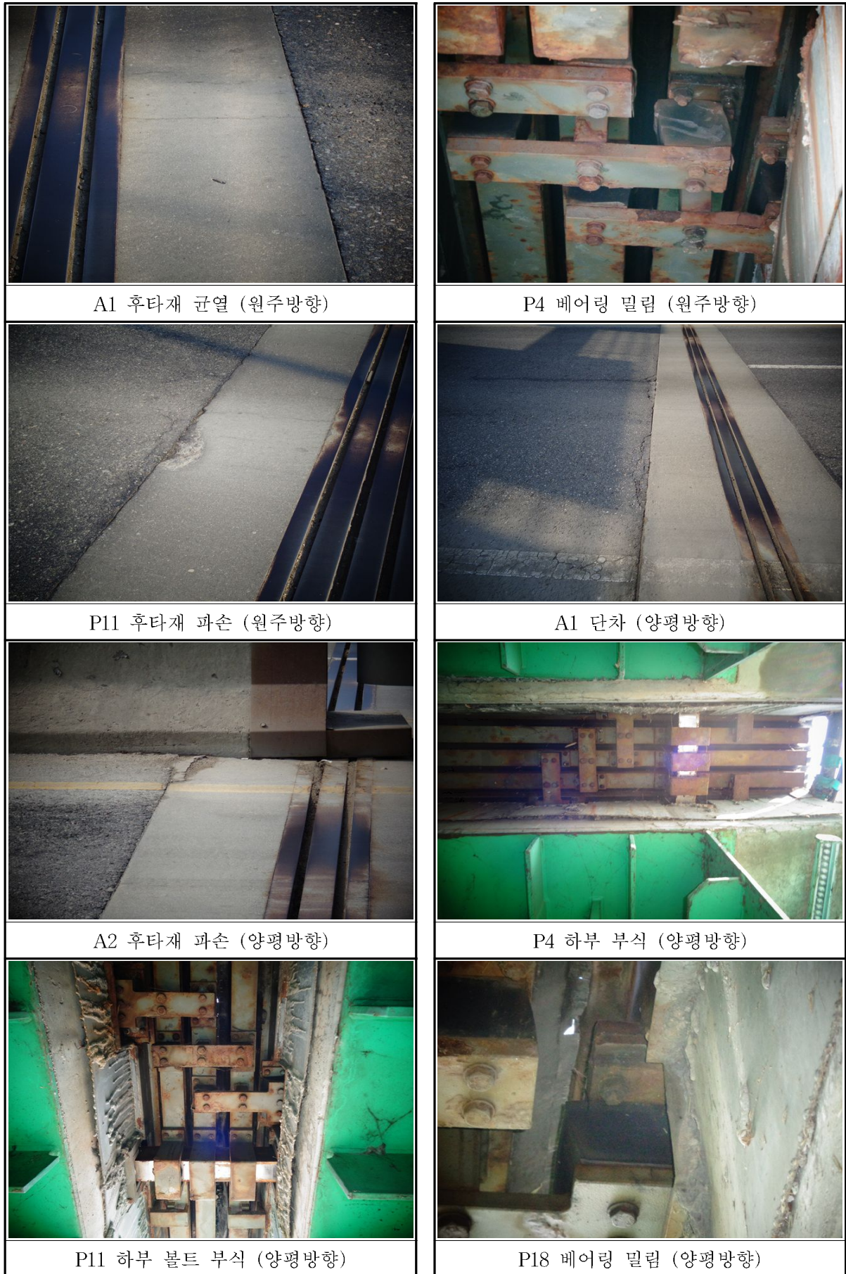
【그림 3.17】 신축이음장치 손상 현황
