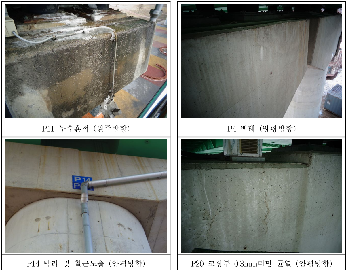
【그림 3.14】 교각 손상 현황
