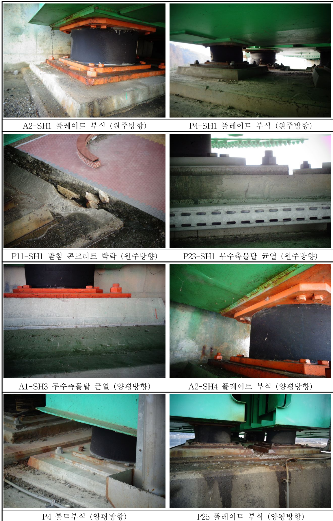
【그림 3.15】 교량받침 손상현황
