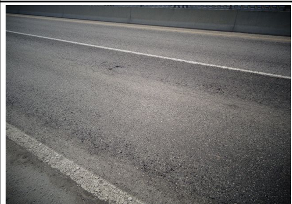
S15 망상균열 및 소성변형 (양평방향)
